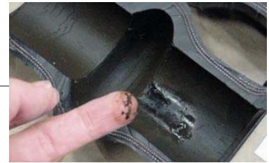
↑上水ラインのゴム劣化によるカーボン流出事例
